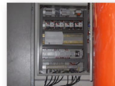
Fig.10 : Photo du coffret de régulation
