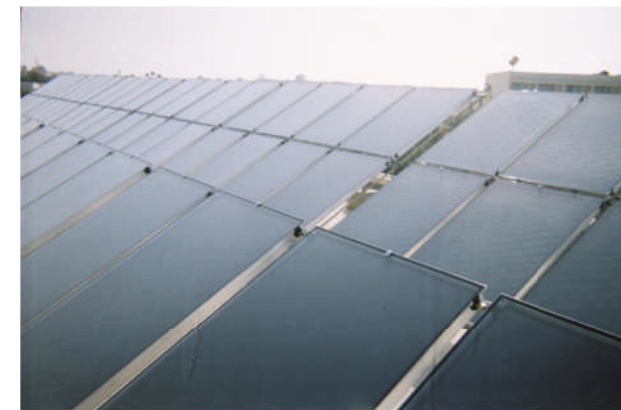
Fig. 3 : Photo de batteries de capteurs
